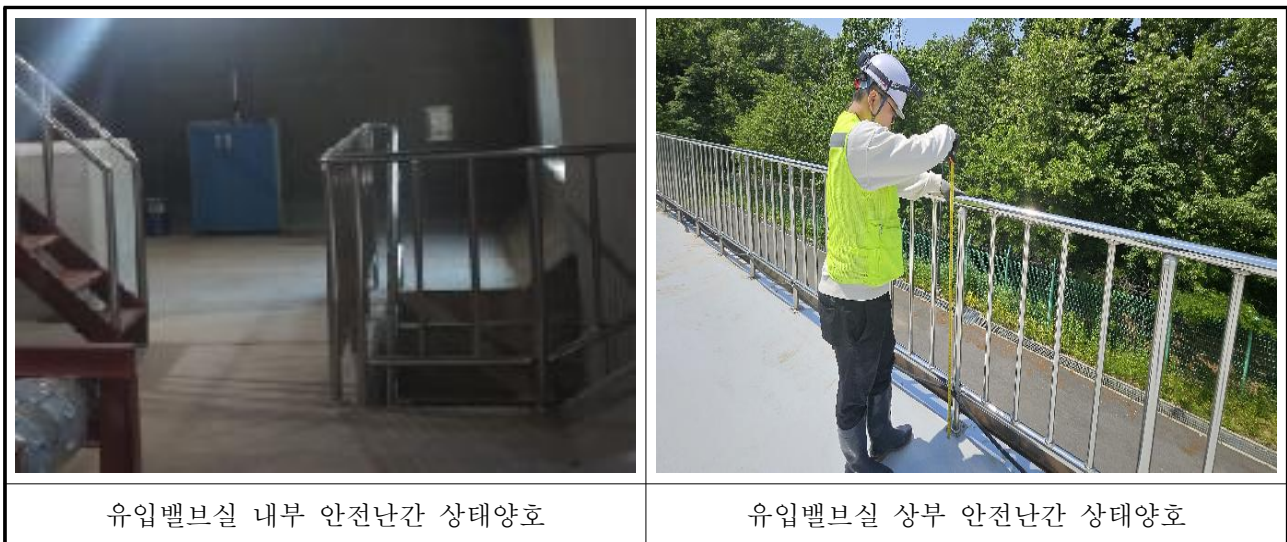
【사진 3.8】 추락방지시설 손상사진
