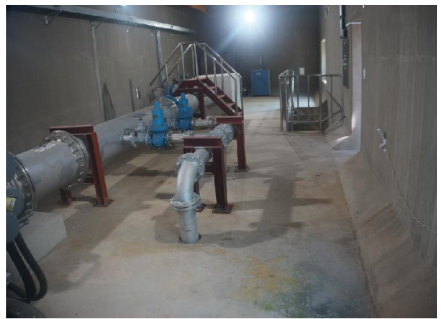
유입밸브실 배관설비 상태양호
