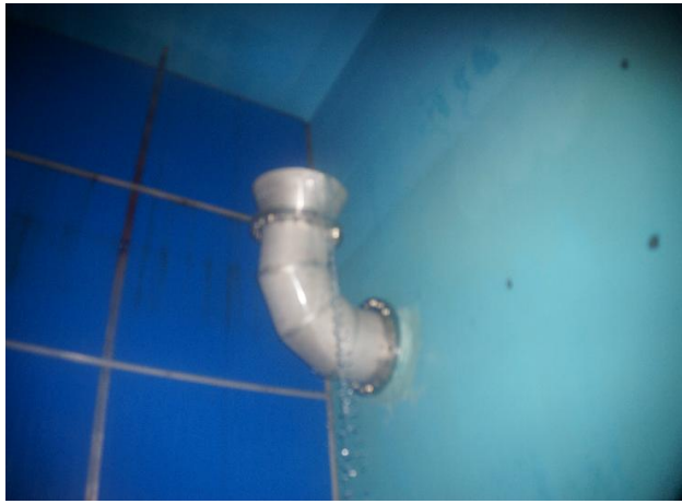
배수지 1지 유입관 상태양호
