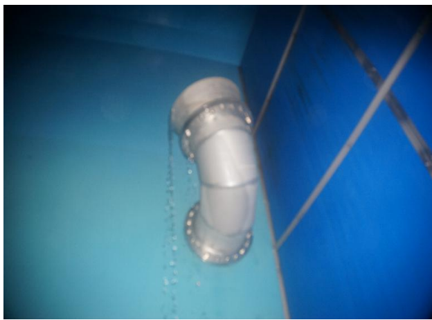
배수지 2지 유입관 상태양호
