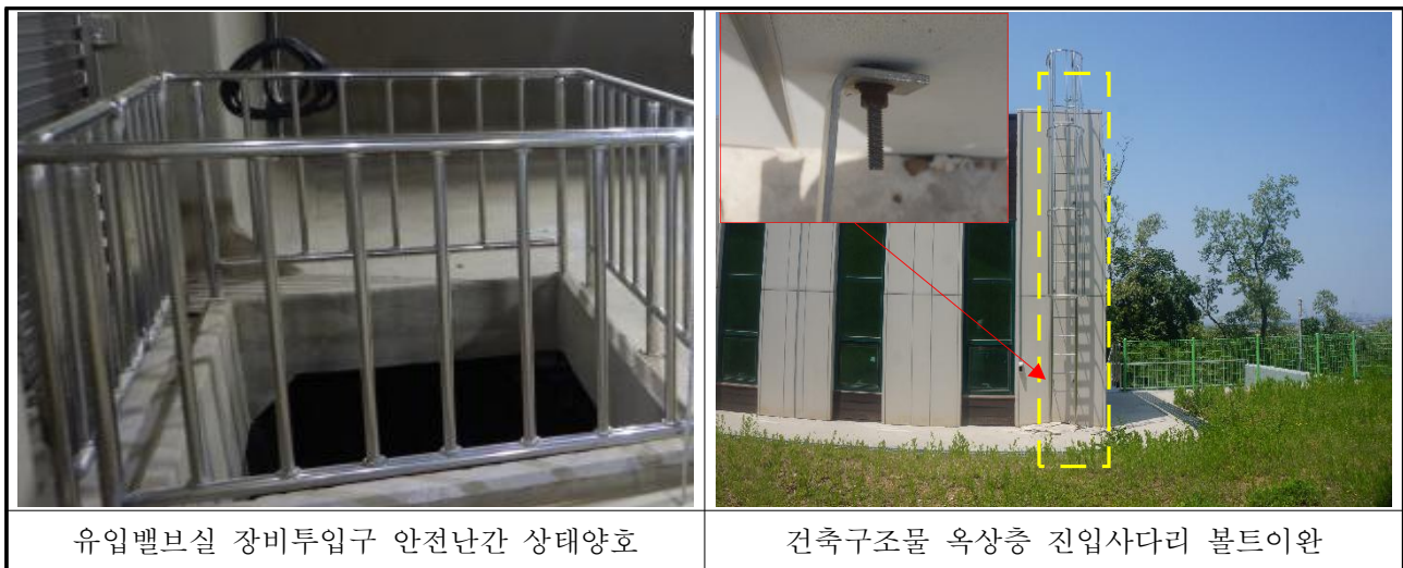
【사진 3.7】 안전시설(점검로) 손상사진(계속)
